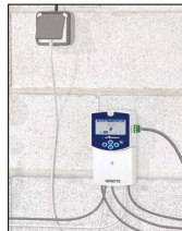
FR Branchement électrique de la centrale après fermeture du capot. UK Powering up the smart controller after closing the cover.
