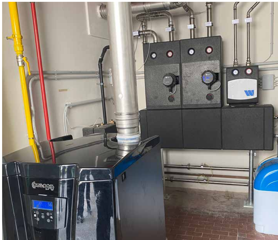
Centrale termica e gruppi di rilancio e miscelazione
