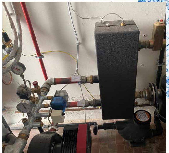
Valvola di intercettazione combustibile e altri componenti
